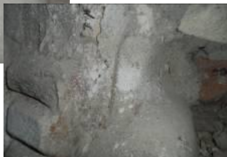
Figura 8. Detalle de manchas blancas. (Foto: E. Pérez, 2013).
