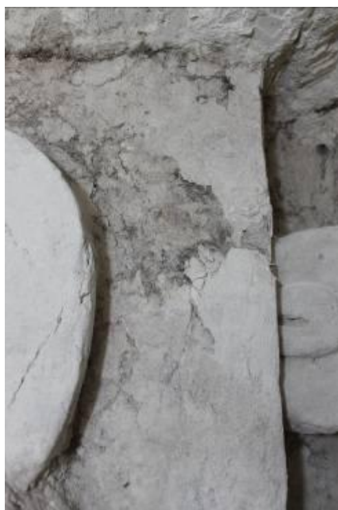
Figura 28. Grietas, fisuras y desprendimientos por raicillas. (Foto: M. Colín, 2013).
