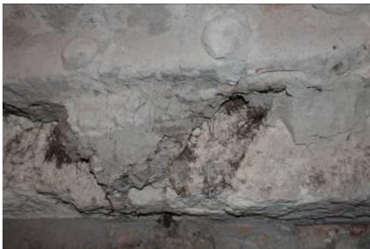
Figura 6. En el centro de la imagen se observa crecimiento de raicillas entre la piedra y el estuco. Resanes aplicados en temporadas anteriores y que ya no son funcionales. (Foto: M. Colín, 2013).
