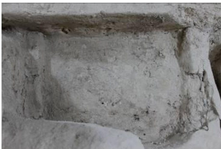
Figura 34. Ojo con restos de color negro. Al lado derecho de la imagen también se observan grietas y desprendimientos. (Foto: M. Colín, 2013).
