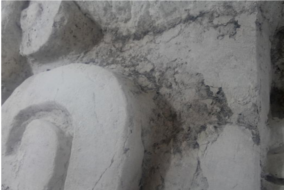
Figura 3.15. Ejemplo de daños causados por raíces en el Mascarón 2 después de la conservación (foto por T. Garrison).
