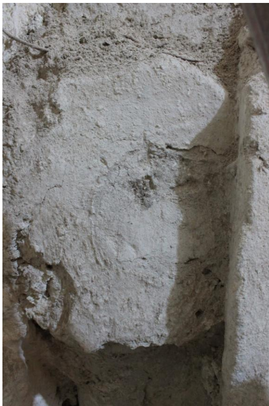
Figura 45. Detalle de marca donde se encontraba elemento decorativo desprendido. (Foto: M. Colín, 2013).
