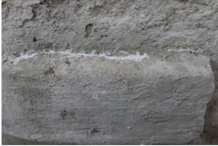
Figura 39. Grieta consolidada después de inyección. (Foto: M. Colín, 2013).
