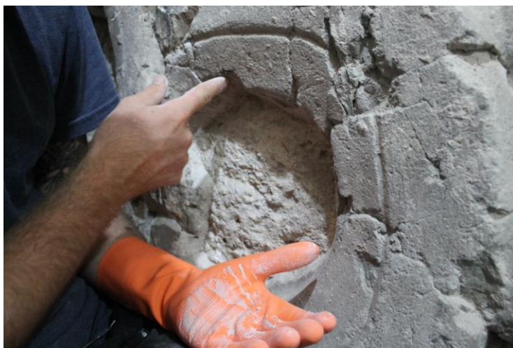
Figura 23. Aplicación de mortero como resane de sacrificio en zona abrasionada. (Foto: M. Colín, 2013).
