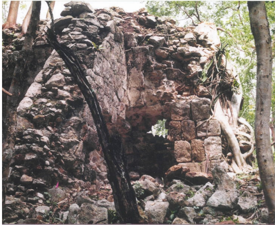
Figura 6.9. N0970E0850 (Edificio de los Diamantes). Lado oeste del cuarto 1 antes de ser intervenido.
