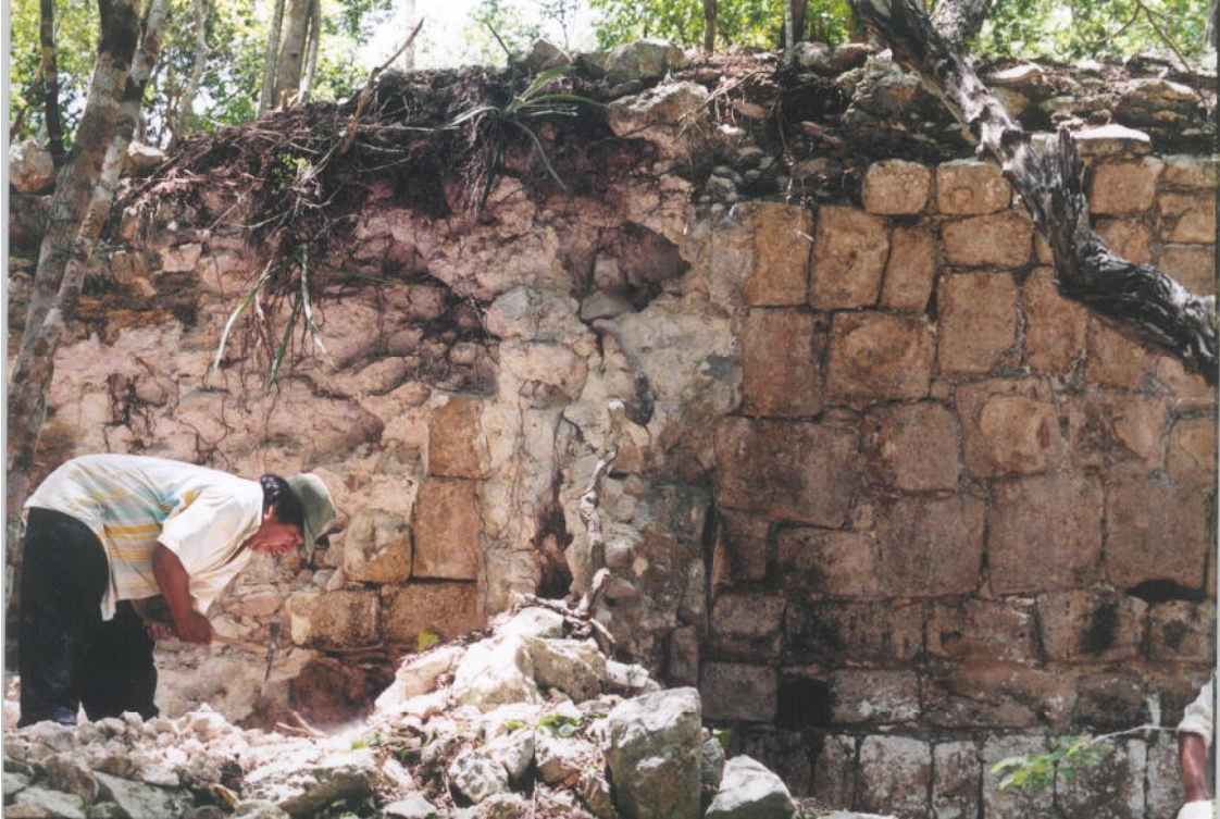
Figura 6.1 Ala Este de N0895E0885. Vista del extremo SW del cuarto 9 y del muro que lo divide del cuarto 8, antes de su intervención.
