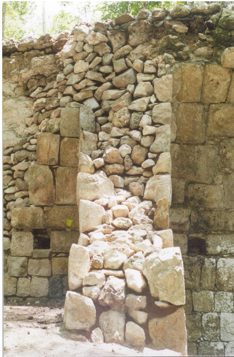
Figura 6.5. N0895E0885. Extremo SW del cuarto 9 y muro que lo divide del cuarto 8 después de su consolidación.
