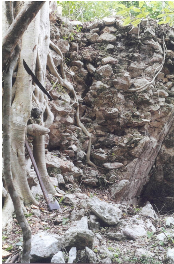
Figura 6.10. N0970E0850. Lado este del cuarto 5 antes de ser intervenido; nótese las grietas en la pared divisoria de las dos bóvedas.
