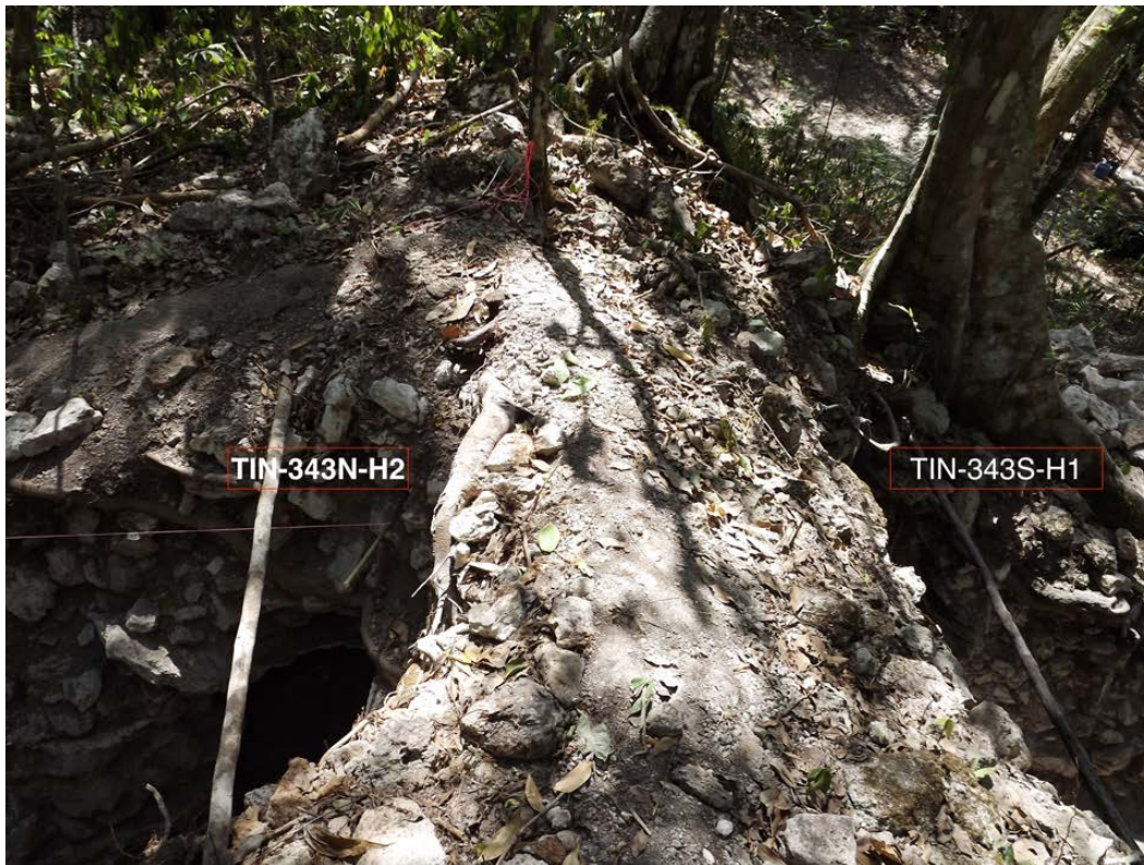
Figura 4.37a. Arriba se muestra el muro que separa los cuartos sur y norte del extremo este de la Estructura 13K-4, depredado por los saqueadores. Abajo, Daniel Vanegas muestra una posible conexión tapiada entre ambos cuartos (Fotos: V. Matute, PAET).
