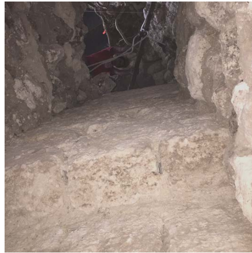
Foto 2.22. Pozo de la Unidad TIN-100-T2, vista hacia arriba de moldura y talud (Foto: H. Pérez, PAET).
