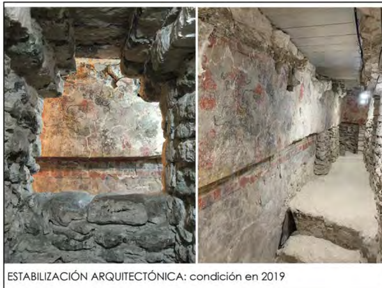
Figura 5.1. 4. Situación actual de muros y vigas de túneles (fotografía por H. Hurst 2019).
