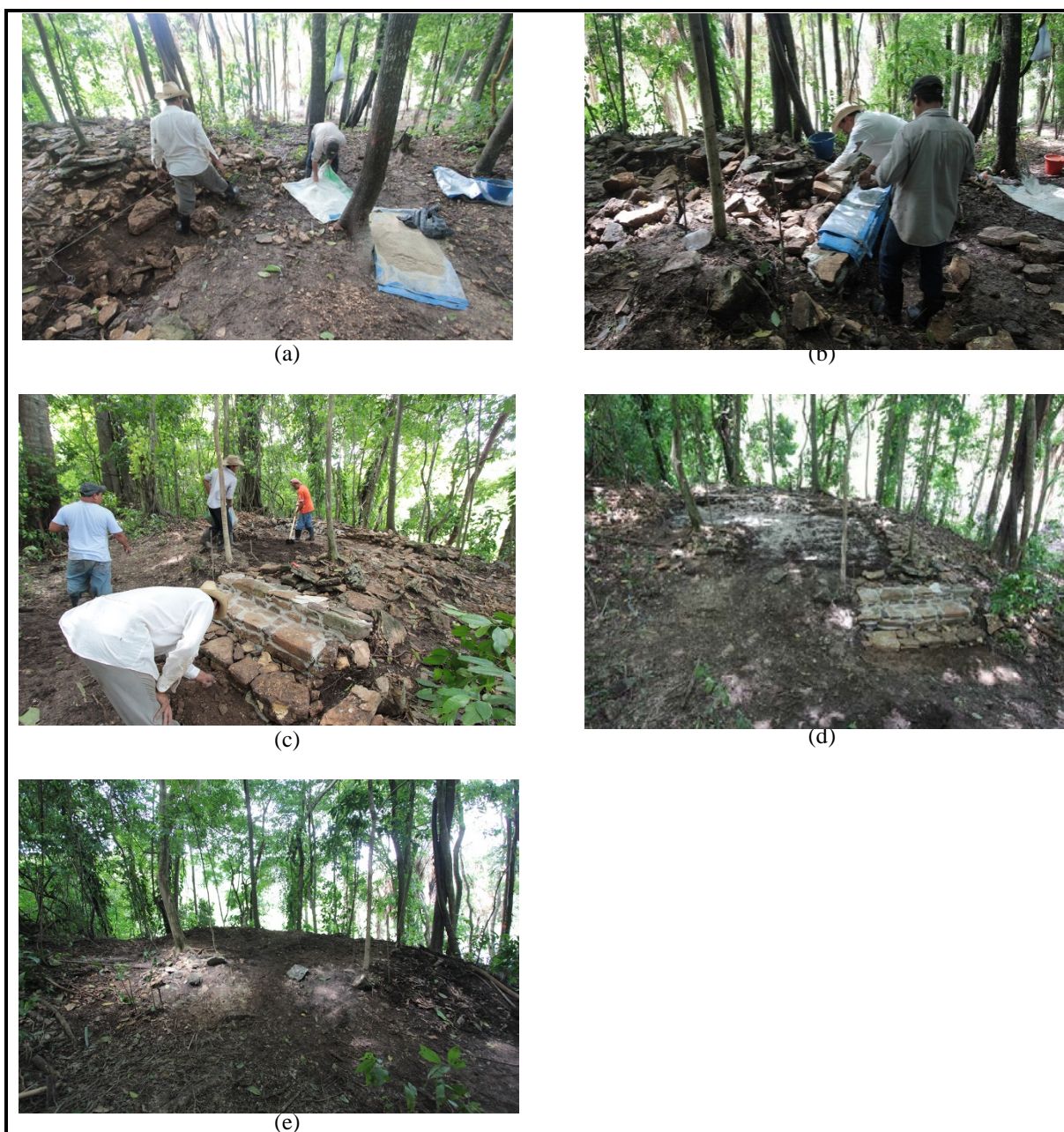
Figura 2.21 Estabilizando y rellenando la arquitectura expuesta en BU-6B, Estructura D7-3: (a) preparando la mezcla, (b) arreglando las hileras de piedras talladas, (c) tapando la superficie con tierra preparada, (d) consolidación completa mostrando la capa de sascab , (e) la Estructura D7-3 al terminar el trabajo, cubierta de nuevo con suelo y hojas (fotos por C. Golden).
