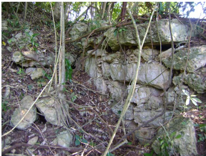
Fig. 2. 7. La parte de la crujía de la estr. K-5 que se desarrolla en sentido este-oeste, apoyándose finalmente a la ladera del cerro (foto A. Campiani)
