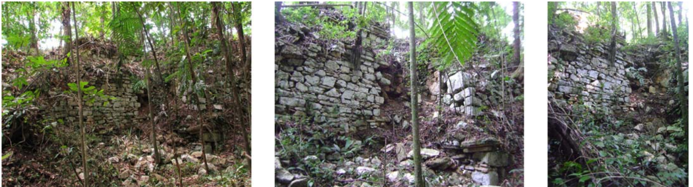
Fig. 2. 36. El frente sur del edificio A-9 (foto A. Campiani y E. Mirón 2008, 2010 y 2011)
