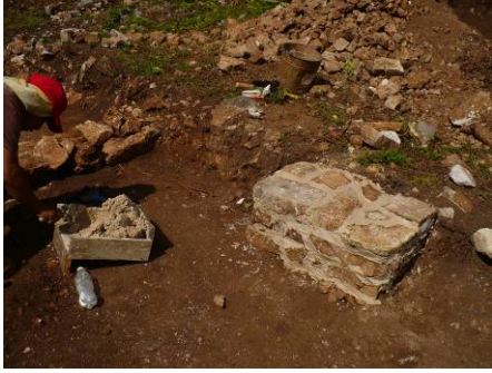
Fig. 10. 20. Operación 161: Una vez concluida la consolidación del vano, se procedió con la limpieza del muro medianero en el recinto del Edificio 4.
