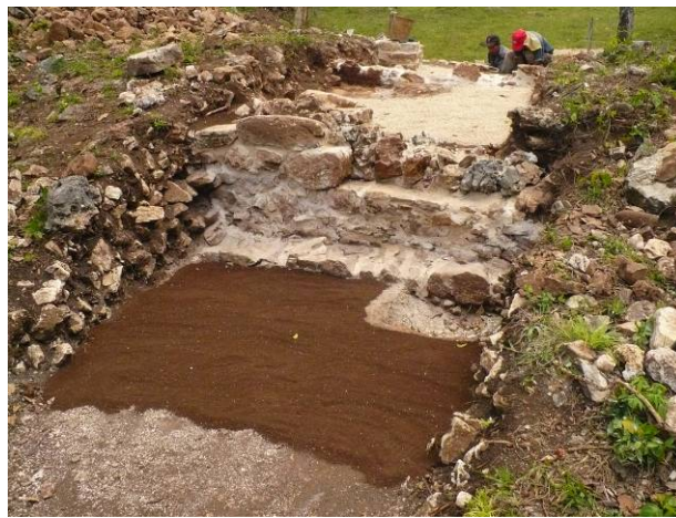
Fig. 10. 41. Operación 161: Vista general de la cala desde el muro posterior ya terminado el trabajo de consolidación.
