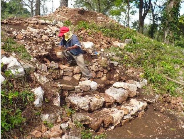
Fig. 10. 4. Operación 16: Remoción de escombros y materiales disgregados en la porción superior del basamento del Edificio 4.
