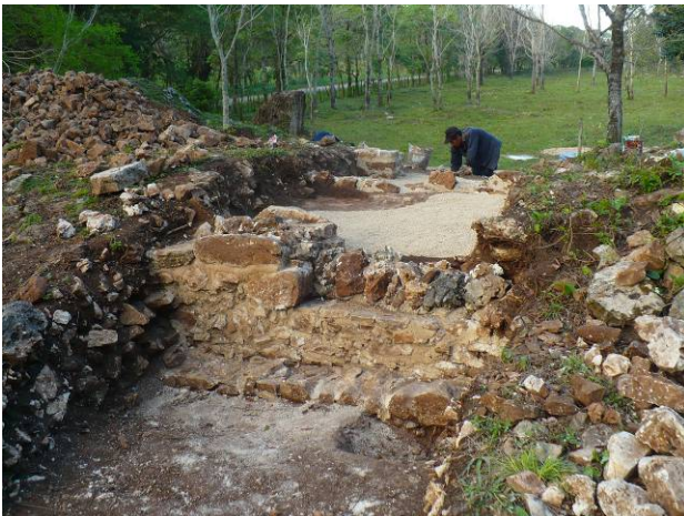
Fig. 10. 37. Operación 161: Aspecto del muro posterior con la incorporación del núcleo para indicar el límite del recinto.
