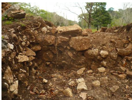
Fig. 10. 28. Operación 16: Vista del muro posterior donde se aprecian las raicillas que ocasionaron la disgregación de la mampostería.
