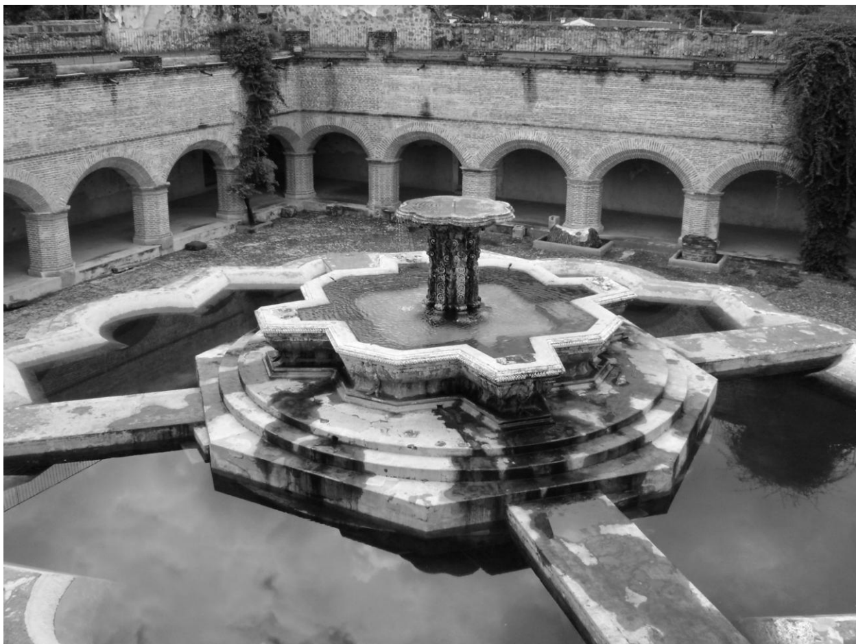
Figura 9 Arcadas norte y este del claustro de La Merced (segunda intervención). No se reintegran los bloques de mampostería colapsados de la arcada este, tampoco se integran los revestimientos
