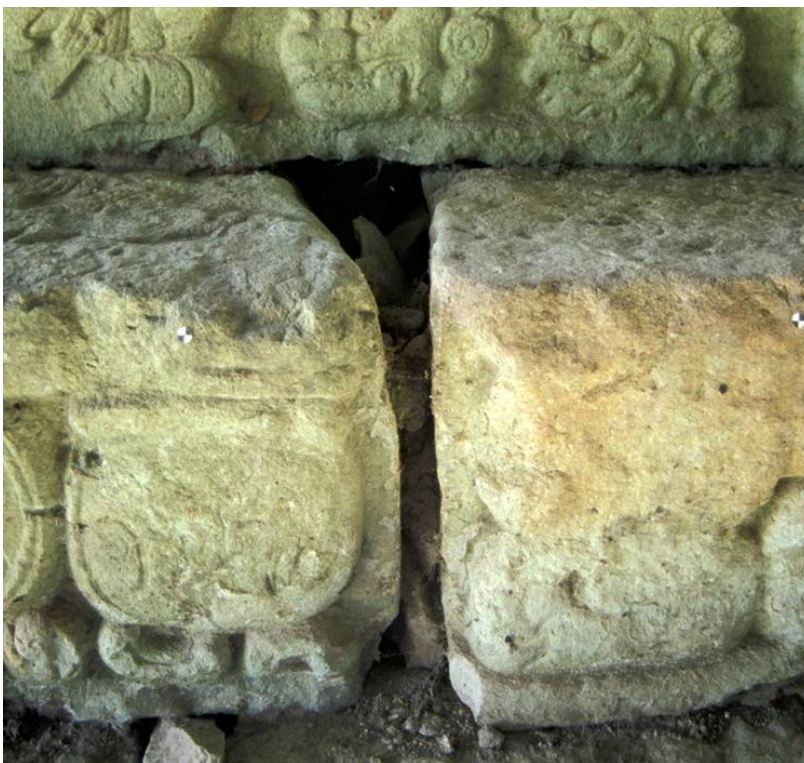
Figura 9 Área de pérdida de mortero entre dos bloques (Foto por Elsa Bourguignon)
