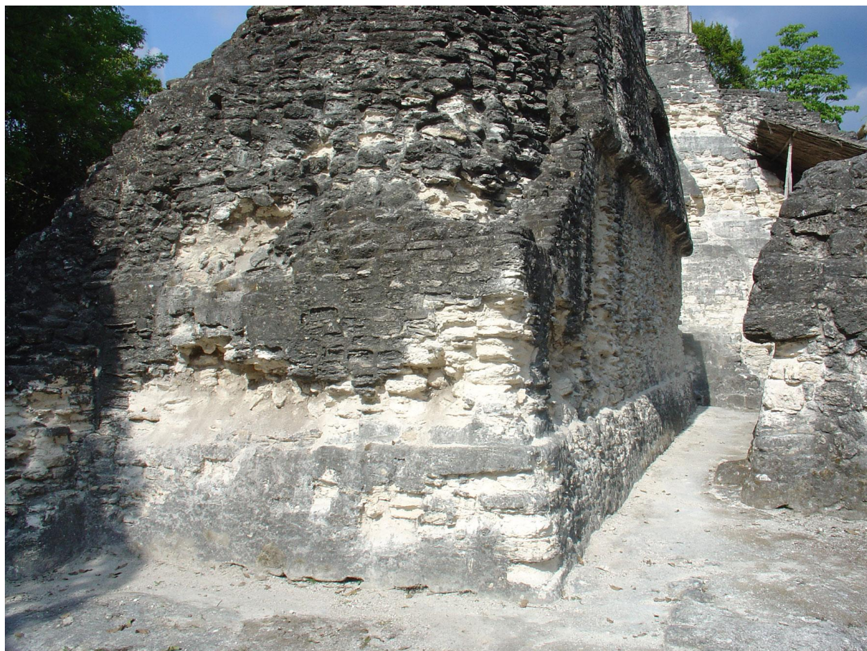
Figura 3 Estructura 5D-20 con deterioro muy avanzado
