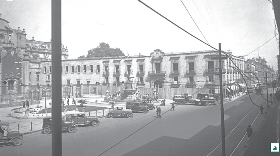
Proceso de demolición del Colegio Seminario y el Colegio de Infantes en 1933: a) Inicio en la fachada principal. b) Trabajos en la esquina noreste. c) Predio liberado.
